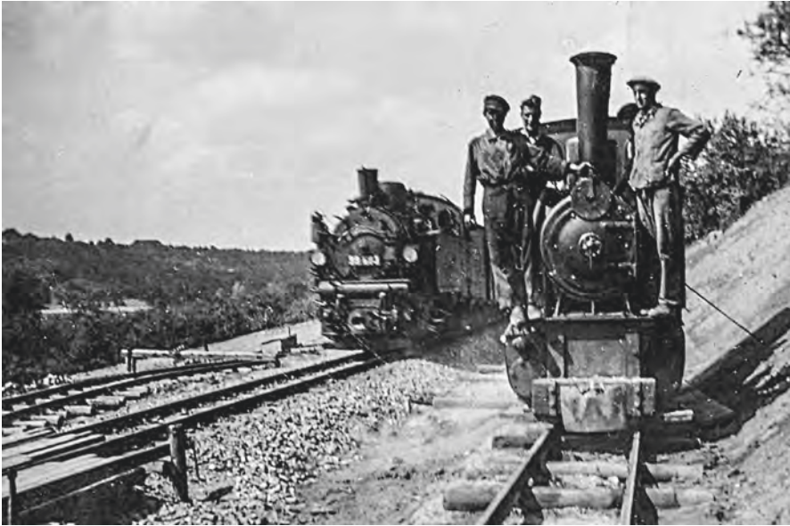
Bau des Anschlussgleises für das Kraftwerk in den Weinbergen von Marbach; links die Dampflokomotive 99 683 der Bottwarbahn auf dem Weg zum Bahnhof Marbach (1938).
