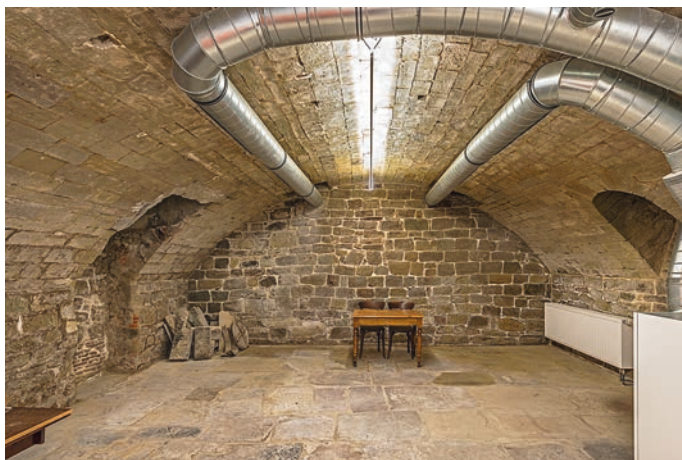
Wie das massive Erdgeschoss, so zeichnet sich auch der tonnengewölbte Keller durch sein qualitätvolles Mauerwerk aus. (Foto: Iris Geiger-Messner LAD)
