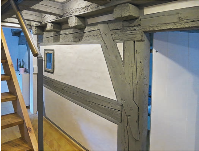
Auf Schritt und Tritt begegnet einem im Inneren die komplexe Baugeschichte des Hauses. Hier verblattetes Fachwerk aus dem späten Mittelalter. (Foto: Gerhard Kabierske)
