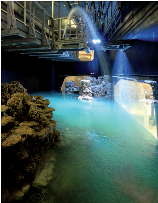
Abbildung 27. Anfang Juli stellt eine Probefüllung des großen Riffbeckens sicher, dass Scheiben und Gewölbe den Wassermassen standhalten.
