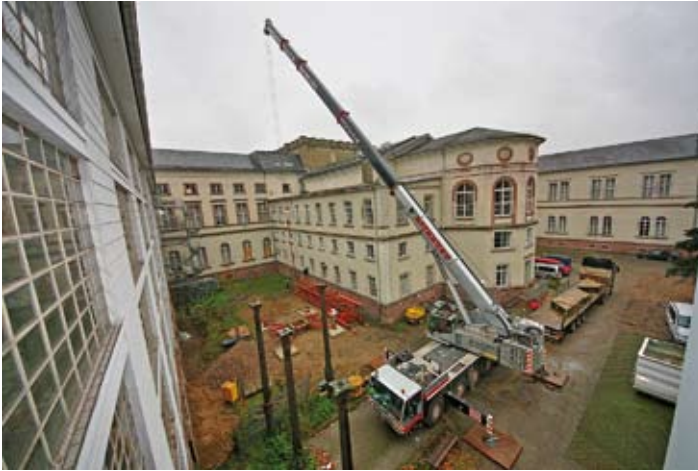
Abbildung 17. Noch steht der nach den Zerstörungen des 2. Weltkrieges nur als „Bücherspeicher“ wieder errichtete westliche Teil des Naturkundemuseums, welcher nun abgerissen wird und als „echter“ Westflügel in alter Kubatur und Geschossigkeit neu entstehen wird. Im Bild sieht man den Beginn der Montage des Baukrans, für den gerade das Fundament gelegt wird.
