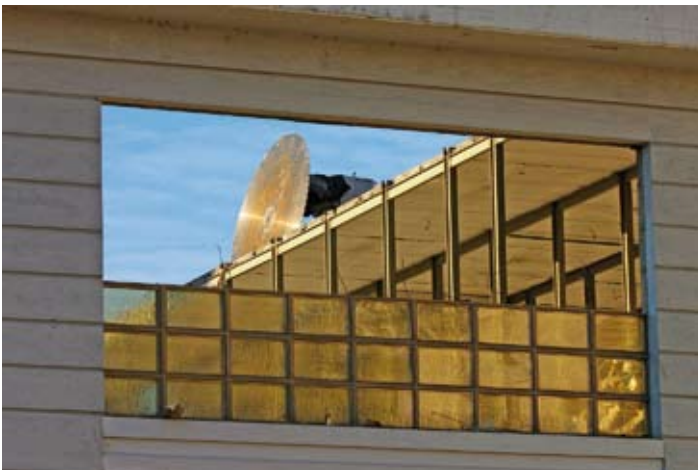
Abbildung 19. Mit überdimensionalen Trennscheiben wird der Stahlbeton des Nachkriegsbaus für den Abtransport fein säuberlich zerlegt.
