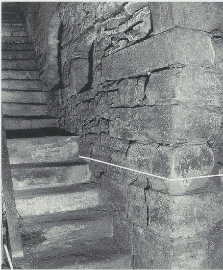
Am östlichen Gewände des Durchgangsbogens erkennt man Erosionserscheinungen im Bereich des schwankenden Wasserspiegels (die weiße Linie gibt die rekonstruierte Wasserstandshöhe an)
