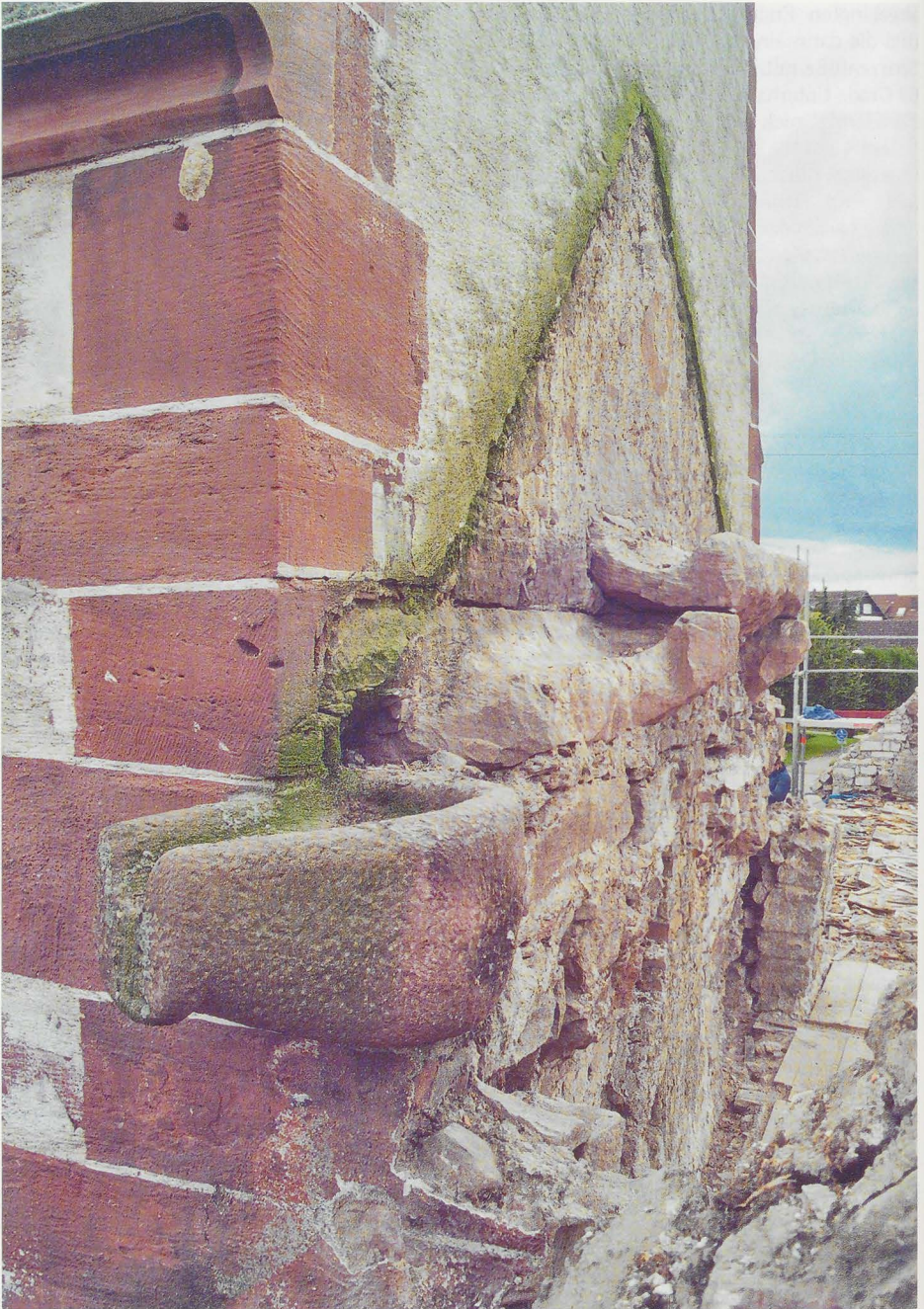
Abb. 4: Denzlingen, ehem. Michaelskirche, Nordostecke des Turms mit Wasserspeier, der das Regenwasser um die Ecke herum abführte
