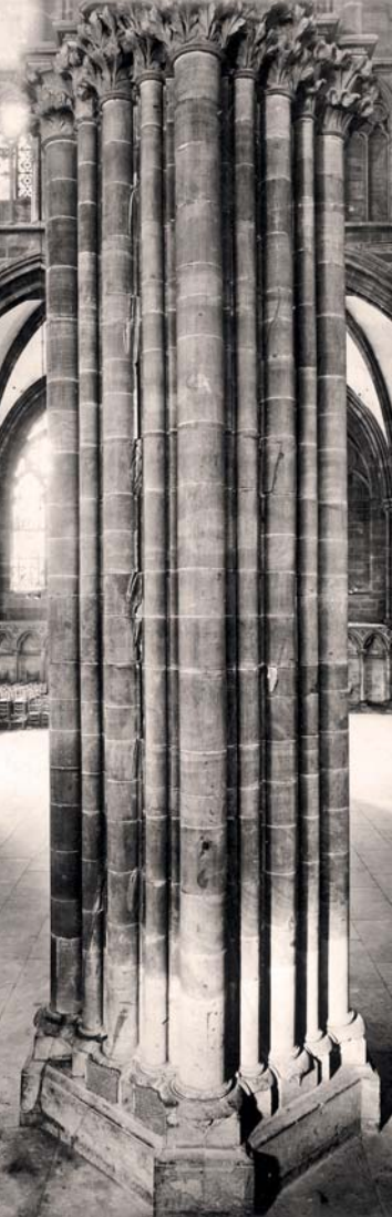
Abb. 7: Erster Pfeiler der Langhaus-Nordseite mit zahlreichen Rissen, 1906
