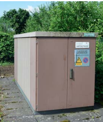
Abb. 14: neue Trafostation 1998 auf dem Grundstück Paul Kuderer (nicht bezeichnete Fotos von Uz.) Hans L. Haffner 2018
