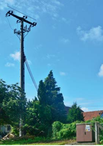
Abb. 13: neue Trafostation und Mast „Im Stück“
