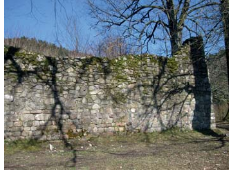
Abb. 3: Die hofseitige Fassade des Turmes; besonders im mittleren Abschnitt ist im unteren Teil noch Kleinquadermauerwerk erhalten.
