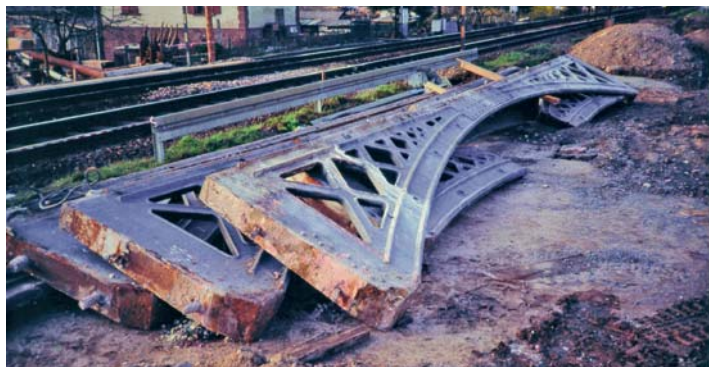
Abb. 8: Abgebaute Randträger bei Ettlingen, 1992_ Boeyng
