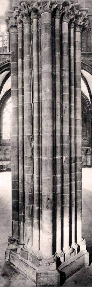
Abb. 7: Erster Pfeiler der Langhaus-Nordseite mit zahlreichen Rissen, 1906
