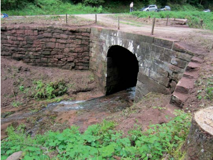
Abb 8: Die in einer vorbildlichen Bürgeraktion freigelegte Staumauer des Floßweihers am Laybach (Foto: W. Schoch)
