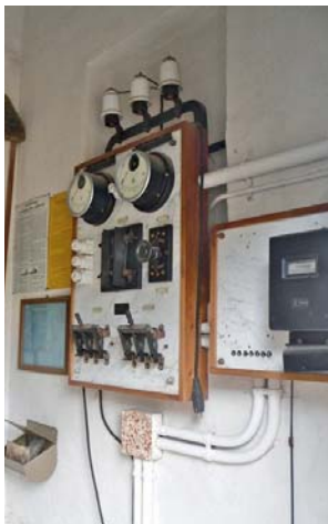
Abb. 10: ehem. Ausstattung; baugleich mit der Turmstation v. 1918 in Kuerbach (Museum); Foto: Pit Fischer 2011
