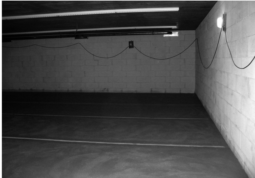
Abb. 32: Neubau Magazin: Einer der noch leeren Räume nach Fertigstellung des Rohbaus (alle Fotos: Landeskirchliches Archiv Karlsruhe)
