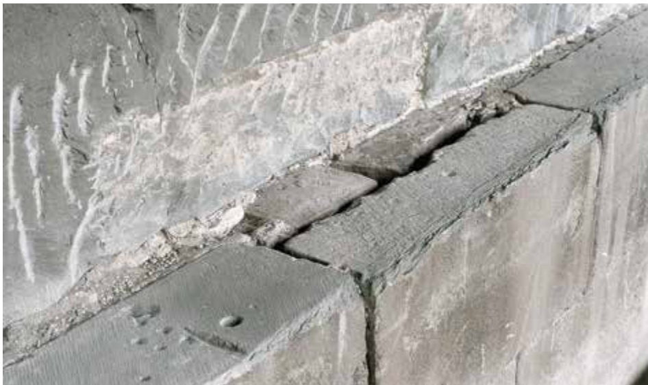
Abb. 44: Einblick in die Mauerstruktur bei ausgespitztem Kaffgesims im Bereich der zweiten Kapelle von Westen mit teilweise sehr geringer Einbindung, von links nach rechts 20, 15 und 19 cm.
