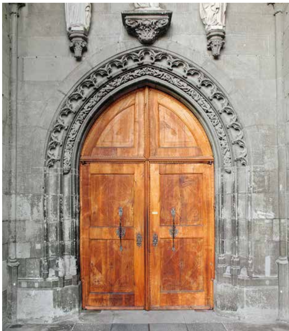
Abb. 26: Südliche Seitenportalöffnung mit Maßwerkvorhang und Laubranken in den Kehlen der Profilierung innerhalb des Spitzbogens.
