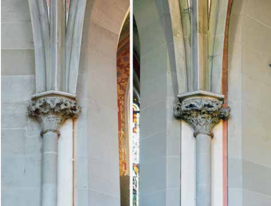
Abb. 16: Stark zur Seite verzogene Kapitelle an der südlichen Scheidwand unmittelbar westlich des Portals (links) und zwischen der zweiten und der dritten Kapelle von Westen (rechts) zum Ausgleich von Unstimmigkeiten zwischen der Lage von Diensten und Gewölbe.
