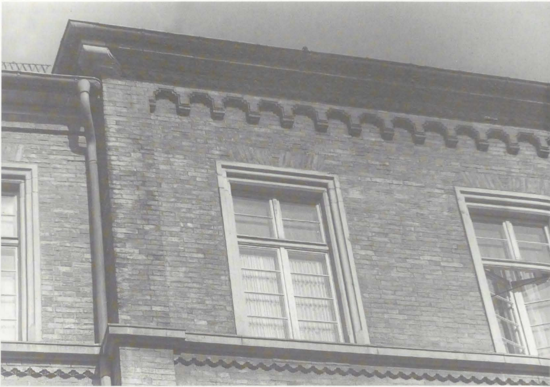
Abb. 12: Fassaden-Detail der Nordfassade mit erneuertem Hauptgesims in der ursprünglichen Form und Stockgesimsen. Links ist die Aufstockung des Seitenflügels zu erkennen, die in Form und Material sehr sorgsam dem Ursprungsbau angepasst wurde.
