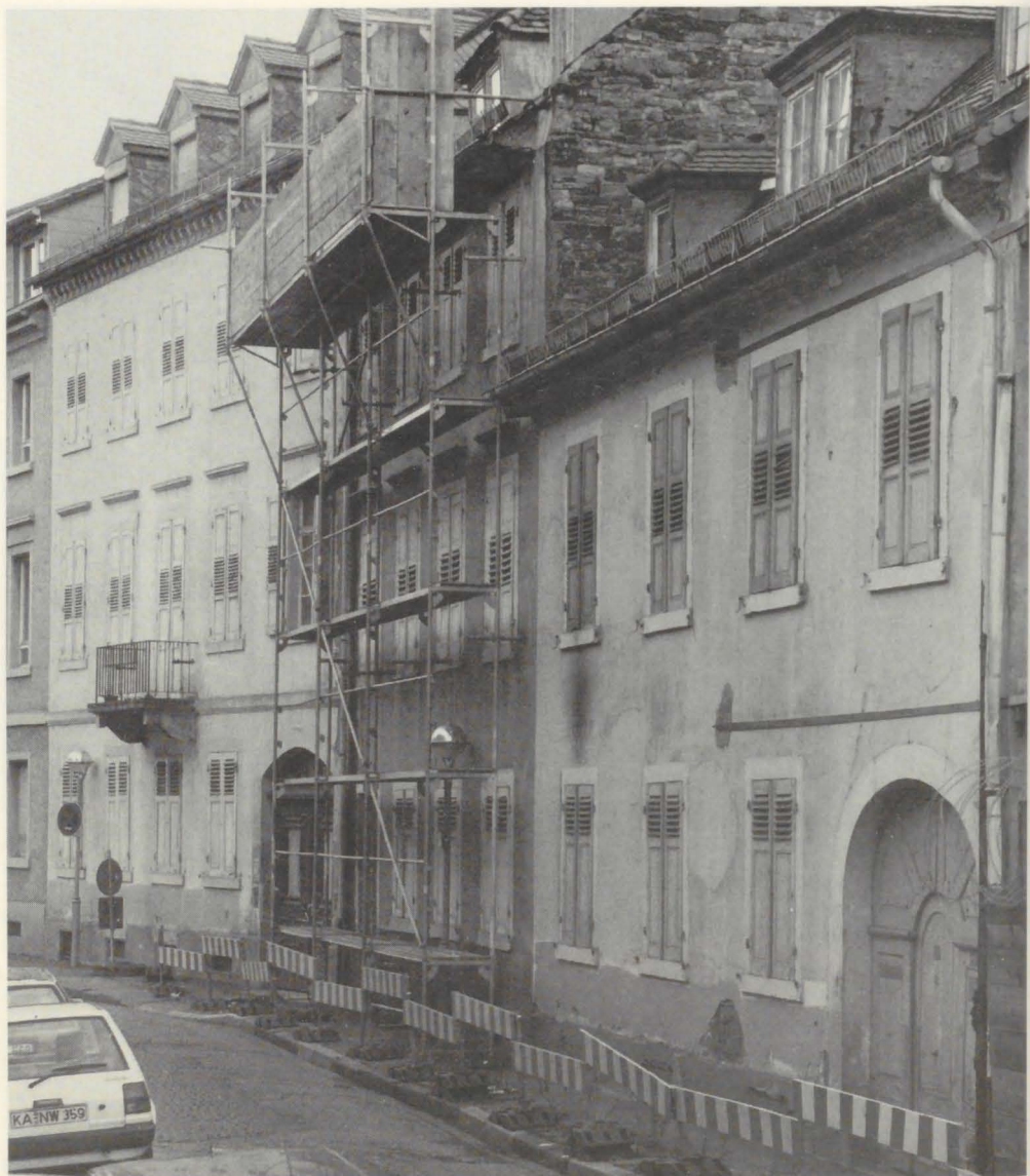
Blumenstraße 9, 11, 13. Modellmäßige, denkmalgeschützte Bürgerhäuser aus der Zeit Friedrich Weinbrenners und Heinrich Hübschs, ein Ensemble, das die Straße prägt und aus ihren Anfangszeiten stammt. Ein Gutachten zeigte auf, daß eine Sanierung trotz der heruntergekommenen Bausubstanz in wirtschaftlich vertretbarem Rahmen möglich wäre. Das letzte Wort liegt beim Regierungspräsidium als oberer Denkmalbehörde. Bis dahin erbält ein Haus ein Notdach.
