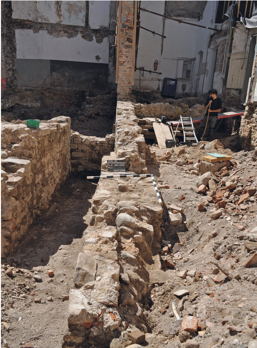
Abb. 6 Freiburg, Universitätsstraße 2 und 4. Die ursprünglich im 12. Jahrhundert angelegte Parzellenmauer war mit zahlreichen Umbauten in unveränderter Lage bis in dreigeschossiger Höhe erhalten (Landesamt für Denkmalpflege).
