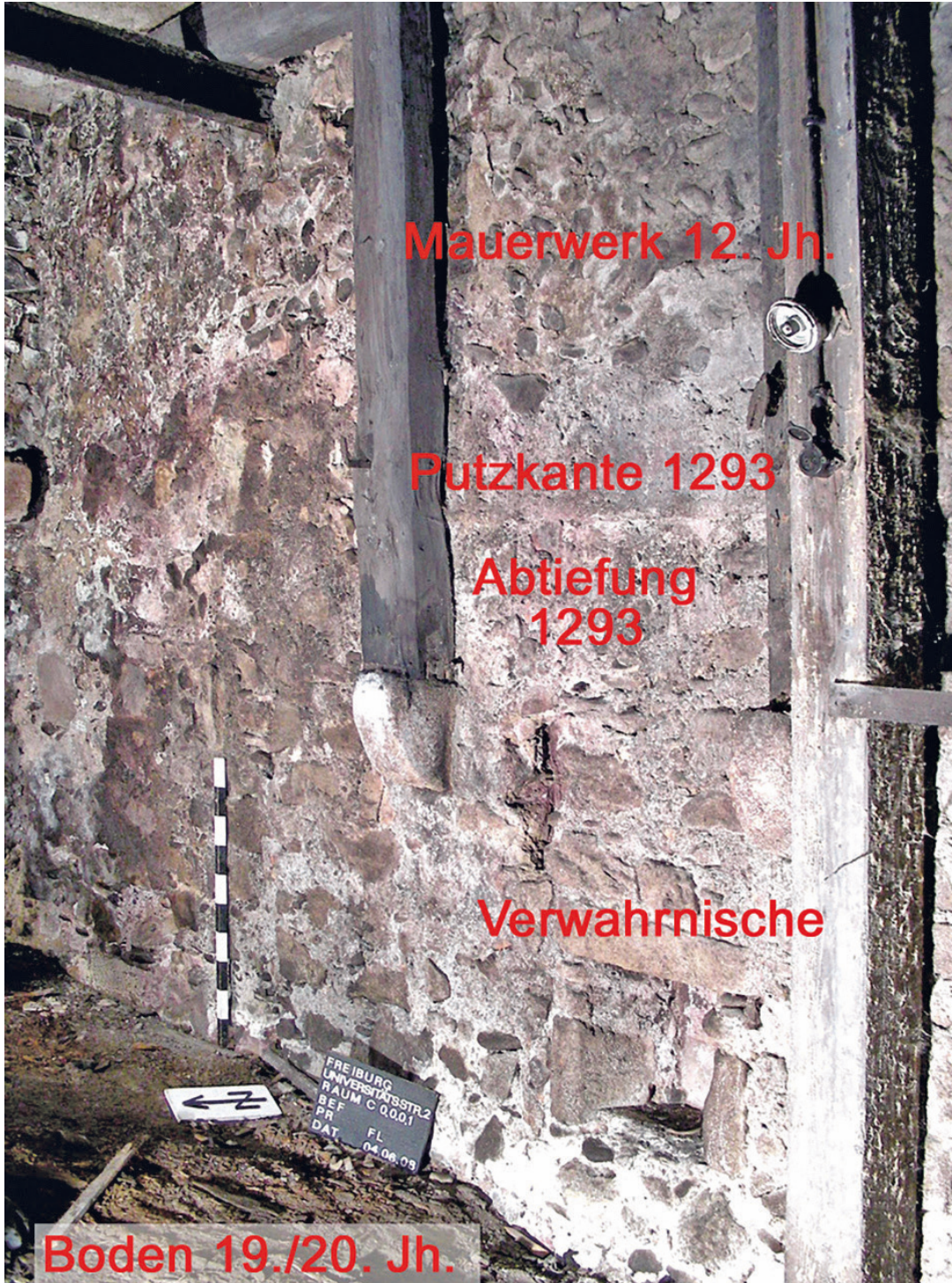
Abb. 5 Freiburg, Universitätsstr. 2. Kellermauer des 12. Jahrhunderts, darunter Mauerwerk der Abtiefung von 1293 mit Konsolsteinen für die damals eingebaute Zwischendecke (Foto: Frank Löbbbecke).
