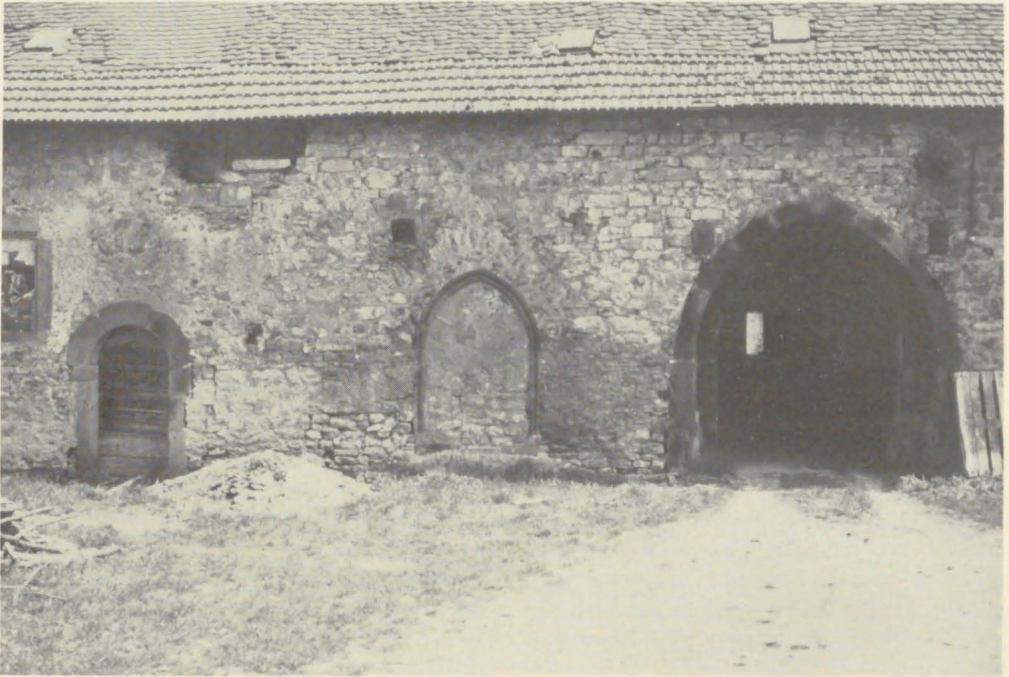
Ostflügel 1988, romanisches Tor zur Sakristei und Kapitelsaal, vermauertes spätgotisches Fenster, frühgotisches Tor zum Dormitorium
