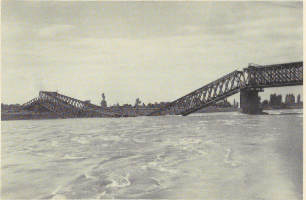
Am 7. Oktober 1939 sprengten die Franzosen die Neuenburger Rheinbrücke (Bild: Stadtarchiv Neuenburg am Rhein)
