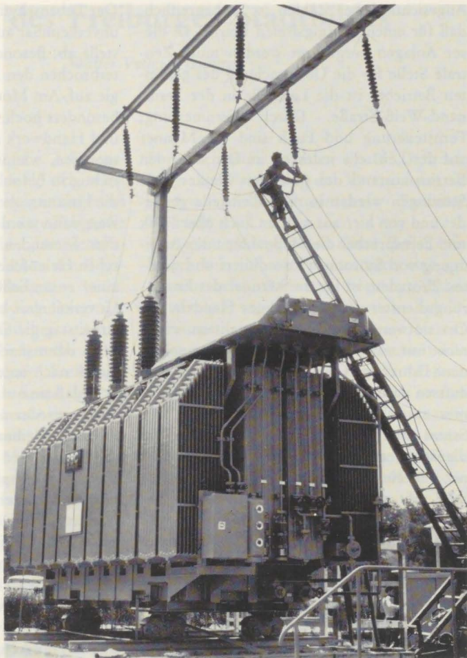
Wartungsarbeiten an den Zu- leitungen zu einem Groß- transformator in der Ferdi- nand-Weiß-Straße
