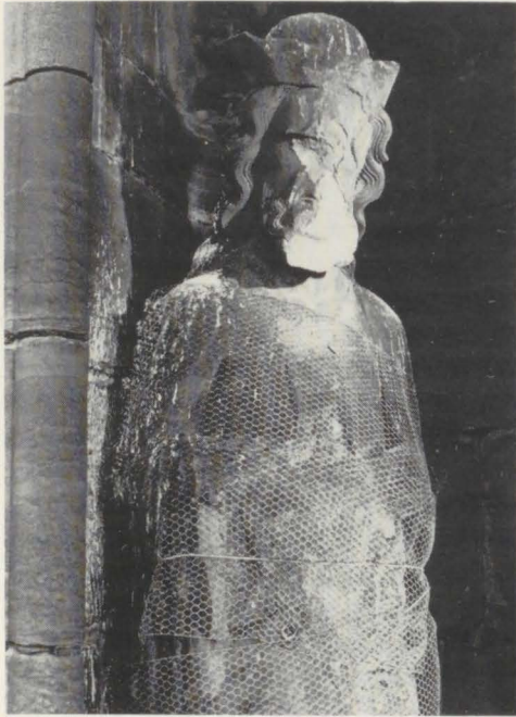
Abb. 1: Prophet am nordöstlichen Dreikantpfeiler in 50 m Höhe: Das Gesicht ist bereits zerstört, die ganze Figur mußte mit Drahtgeflecht gesichert werden, da Teile abzufallen drohten
