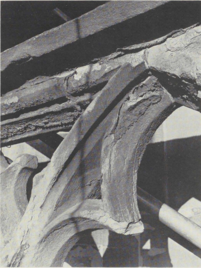
Abb. 4: Maßwerk an der Ostseite der Stern galerie. Deutlich erkennbar sind die Verkrustungen und Absandungen (rechts oben). Die Maßwerks-nase droht in Längsrichtung abzuspalten
