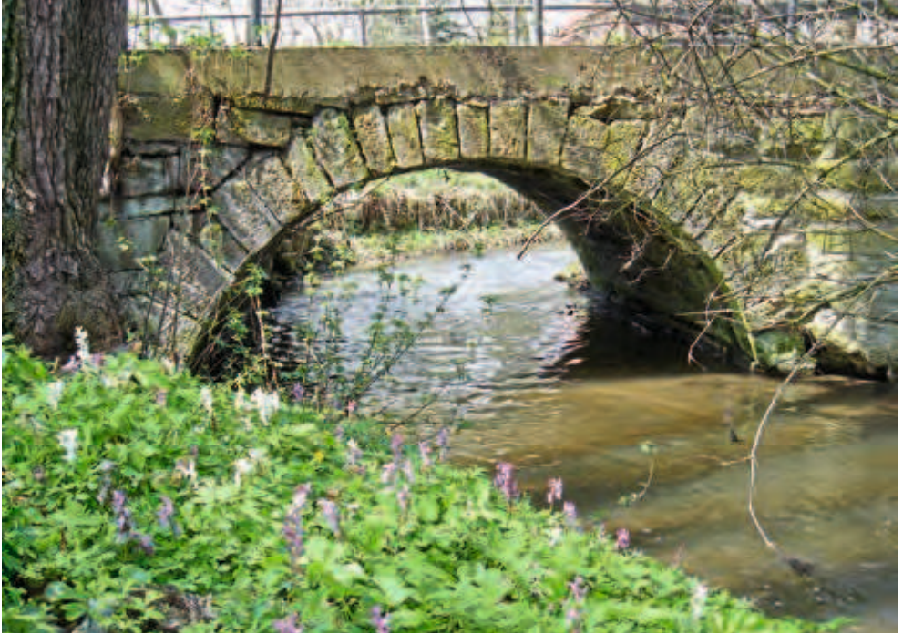
Bogenbrücke an der Glems bei Ditzingen, (etwas unschön) verstärkt mit einem Betonsturz.
