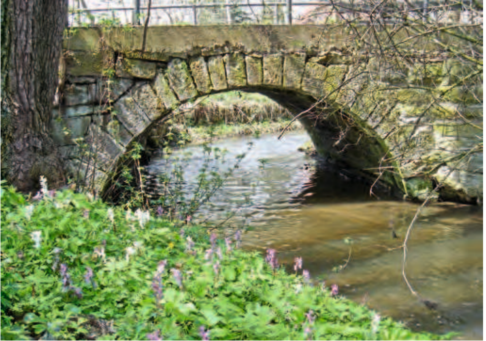
Bogenbrücke an der Glems bei Ditzingen, (etwas unschön) verstärkt mit einem Betonsturz.
