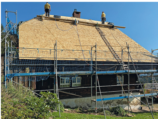
Das ehemalige Strohdach wird mit Holzschindeln eingedeckt (Foto: Förderverein Rankmühle e. V.)
