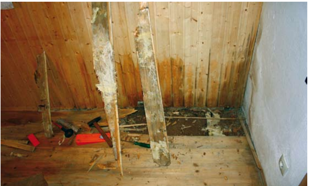
Abbildung 2. Die Ausbreitung des Hausschwamms auf dem Substrat erfolgt zunächst mit weißen Mycelsträngen, hier in einem Haus in der Oberpfalz, August 2010.– Foto: M. SCHOLLER.
