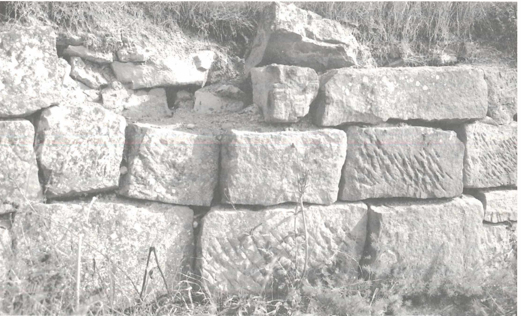
Abb. 19 und 20: Trockenmauern sind am Hofberg nicht gerade häufig. Leider sind an den wenigen vorhanden, die meist eine kunstvolle Hand der einstigen Erbauer verraten, zunehmend Schäden, verursacht meist durch "Lausbuben", festzustellen. Fotos R.WOLF (Juli 1988).
