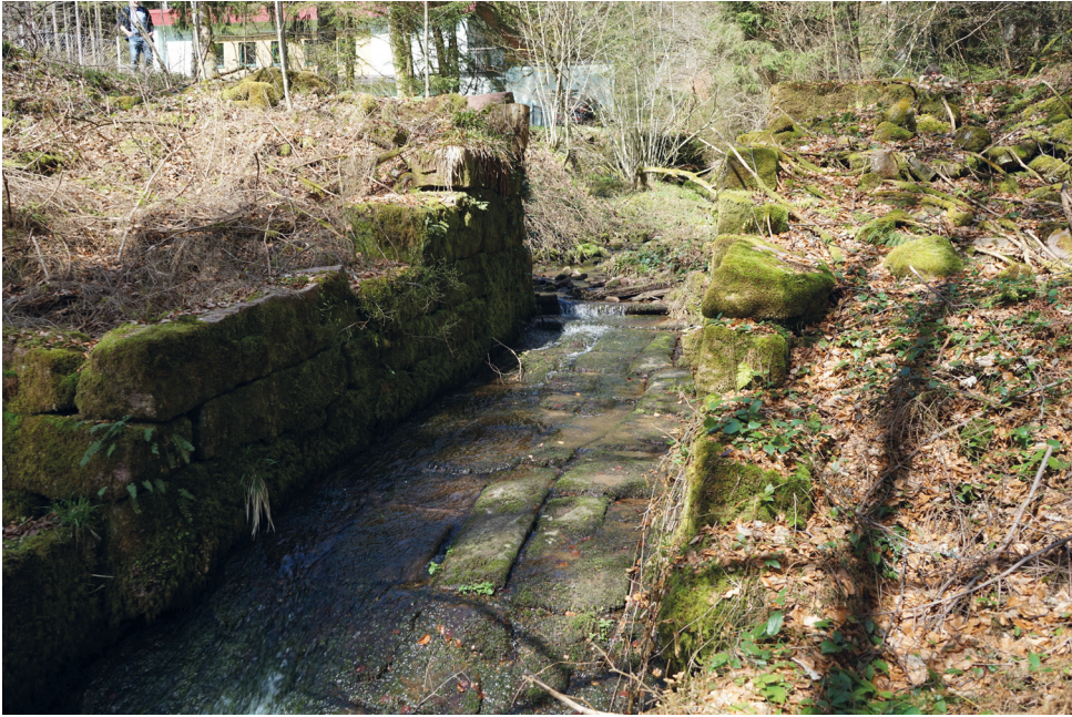
Abb. 77: Damm des Lohmühleweiher; sehr gut erhalten ist das Sohlpflaster. Foto: Werner Konold.
