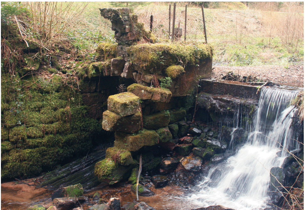
Abb. 72: Schwallung im Ochsengrund, Heubachtal; am Durchlass ist eine Holzpritsche zu erkennen. Foto: Christian Suchomel.
