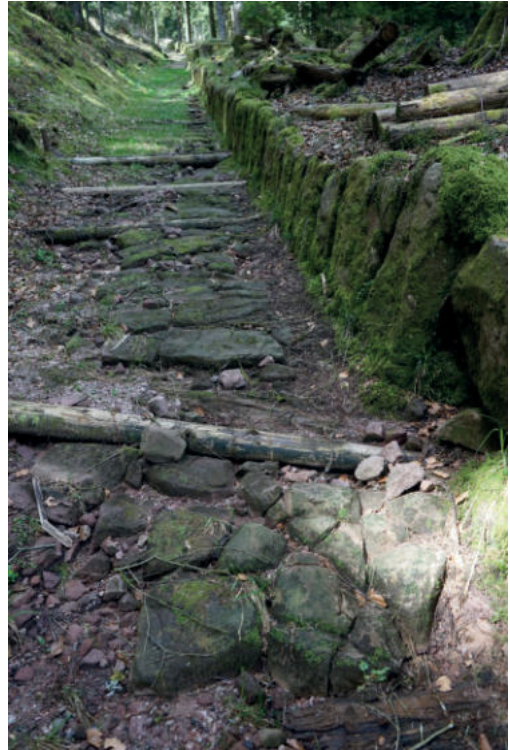
Abb. 30: Wiederhergestellte Riese in Reinerzau mit Steinpflaster, Querhölzern und einer mächtigen talseitigen Mauer. Foto: Werner Konold.
