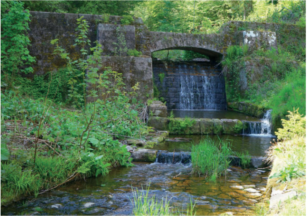
Abb. 64: Der Wolfenweiher an der oberen Wolfach. Unterhalb des Absturzes befindet sich das Tosbecken. Die Bachsohle ist noch ein ganzes Stück weit gepflastert. Foto: Werner Konold.
