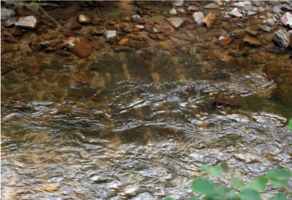
Abb. 69: Sohlenverbau mit Holzbohlen im Dammbereich des ehemaligen Schappenweiher in der Wolf in Vor Wildschapbach unterhalb des Sägewerks Schmid-Holz. Foto: Christian Suchomel.
