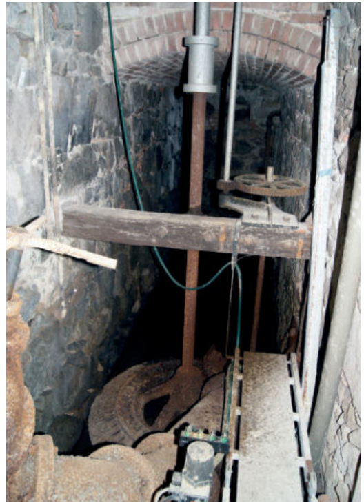
Abb. 18: Turbinenanlage mit Zulaufrohr (vorne links) aus dem Montfortweiher im Tiefkeller der ehemaligen Mühle, erbaut von Camill Montfort 1887. Hauptantrieb für zwei Mühlensteine, Nebenantrieb für Sackaufzug. Foto: Cornelia Korff 2020.
