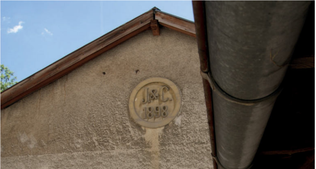
Abb. 41: Eine letzte Investition ins Kraftwerk der von Iselin in Schönau gegründeten Spinnerei und Weberei erfolgte 1898 durch Iselin & Co. (J. & C.) kurz vor Übernahme durch das Bankhaus Mez. Foto: Cornelia Korff 2020.
