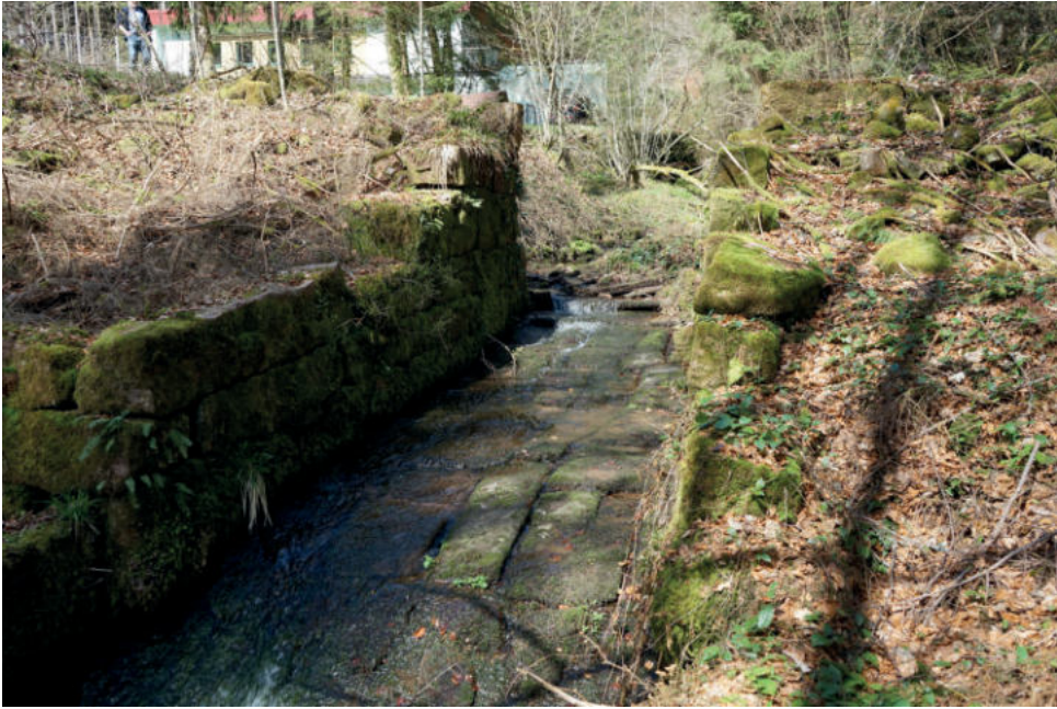
Abb. 77: Damm des Lohmühleweihers; sehr gut erhalten ist das Sohlpflaster. Foto: Werner Konold.
