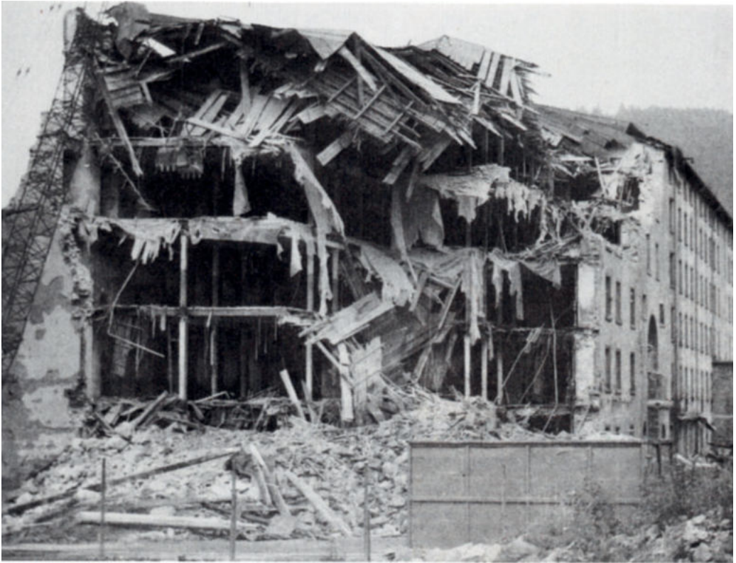
DAS INNENLEBEN der alten Atzenbacher Spinnerei. Mittlerweile liegt rund die Hälfte des alten Industriebaues am Boden. Bild: Hubert Döbele
