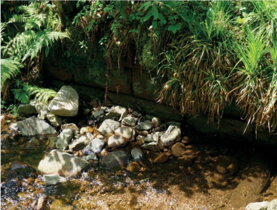
Abb. 86: Steinmauer auf Holzbalken im Schwabach; eine Technik, wie sie in den historischen Quellen beschrieben wird. Foto: Werner Konold.
