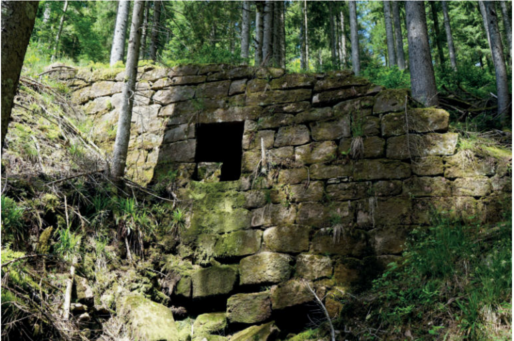
Abb. 34: Steinkonstruktion als Riesunterbau zum Überbrücken eines Bacheinschnitts (Hinterer Absbach). Foto: Werner Konold.
