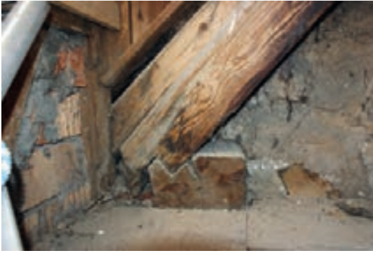
Abb. 29: Villingen, Zinsergasse 16, Detail des Rofenfußpunktes 1349(d).
