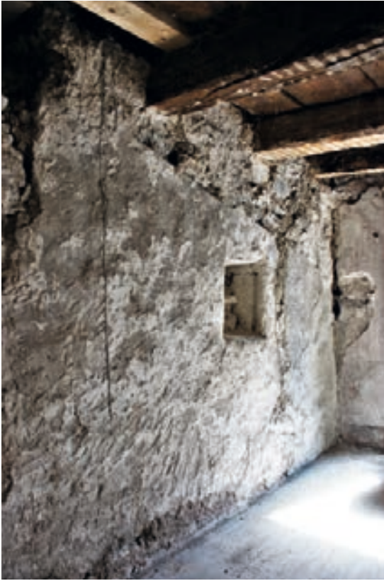
Abb. 34: Villingen, Gerberstraße 14, Putzkante der ehemaligen Pultdachneigung am Nordgiebel.
