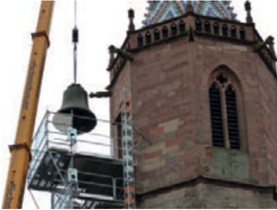
Abb. 25: Am 17. August 2020 wurde die durch einen Sprung beschädigte große Christusglocke aus dem Münsterturm geholt. (Foto: Schultheiß).
