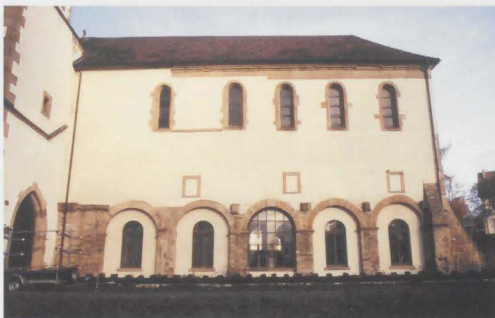
Abb. 7: Klosterkirche Sinsheim, Südseite außen; deutlich sind die unterschiedlichen Bauphasen (rechts kleinteiliger Keuperdolomit, wohl vor 1030; links Quader aus Keupersandstein, 1098/1104) zu erkennen.
