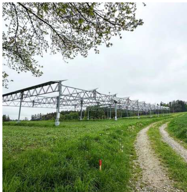
Anlage mit einer aufgeständerten Anlage
