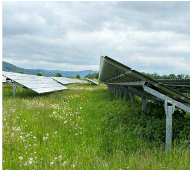
Anlage Solarpark bei Wahlwies mit liegender Ausrichtung
