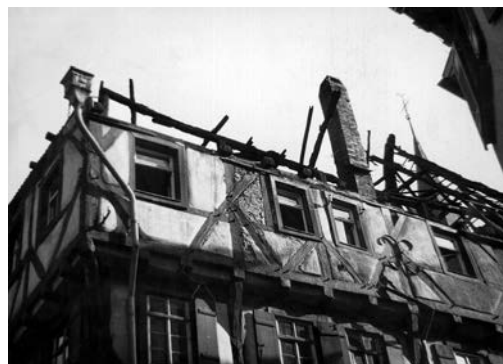
Alte Brauerei Mosbach. Stand hinter der Kirche. Die altertümlichen Verstreibungen weisen auf eine Bauzeit um 1450. Nach dem den Dachstuhl vernichtenden Brand verzichtete man auf die Instandsetzung zugunsten eines Parkplatzes.
