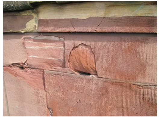
Sandsteinschäden an der Brüstung der Dachplattform 2011. Budde
