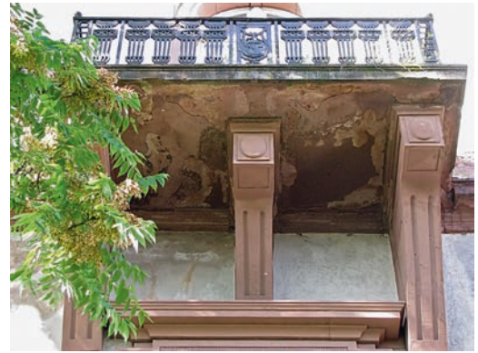
Starke Verwitterung an den Balkons 2011. Budde
