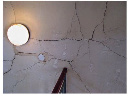
Risse im Putz des Treppenhauses 2011. Budde
