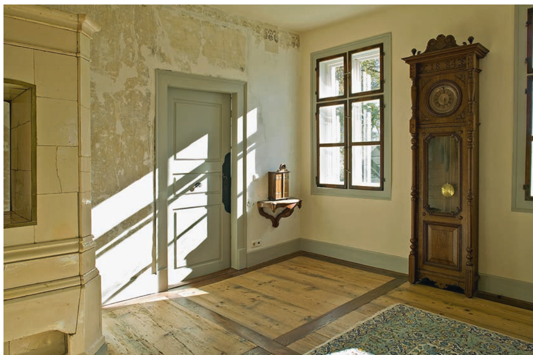
Der »Salon« im zweiten Obergeschoss, die »Gute Stube« des Schlässchens. An der linken Wand Putz und Farbbefunde.
