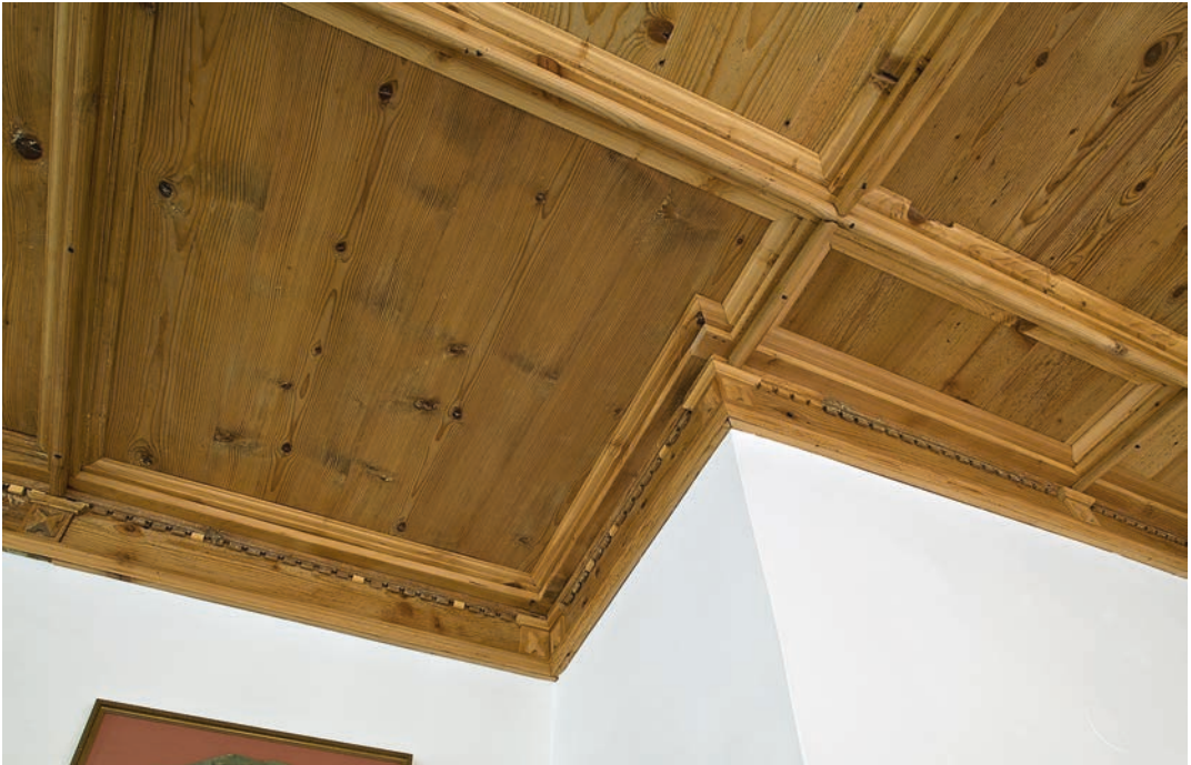
Vorzügliche handwerkliche Reparatur der Decke des Saales im zweiten Obergeschoss.
