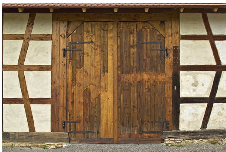
Auch das im 19. Jahrhundert eingebaute Scheunentor blieb erhalten und wurde vorsichtig repariert
