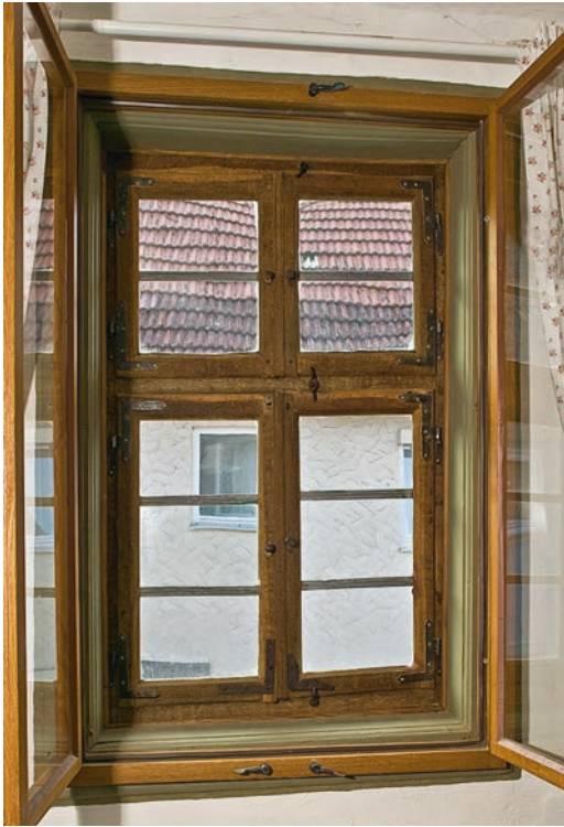
Die sorgfältig restaurierten historischen Fenster wurden für eine bessere Energiebilanz mit zusätzlichen Innenfestern ergänzt
