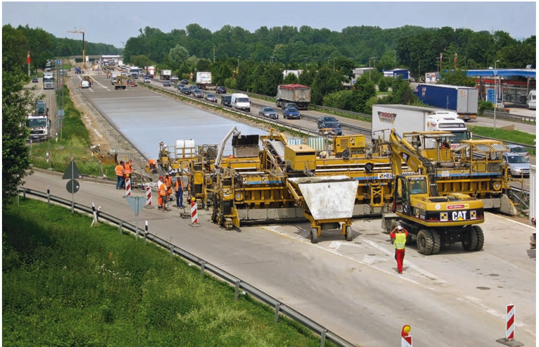
Riesige Betonfertiger mit bis zu 14,50 m (!) Breite haben die neuen Fahrbahndecken auf der Autobahn A 5 in den jeweiligen Bauabschnitten der A-Modell-Strecke fortlaufend an einem Stück eingebaut
