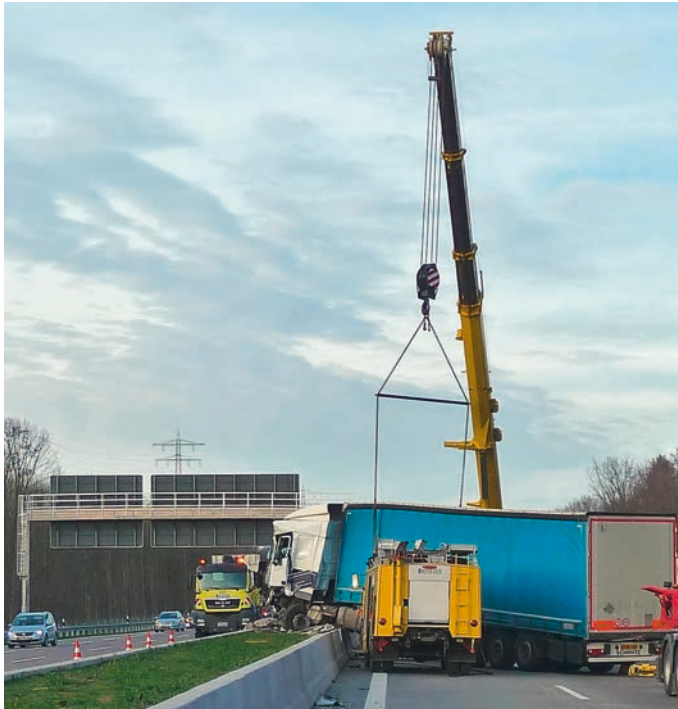
Einer der ersten spektakulären Unfälle auf der neu gebauten A-Modell-Strecke am 8.12.2011 bei Offenburg: Kaum jemand hätte es für möglich gehalten, dass ein Fahrzeug – zumal auch noch ein LKW – auf die neuen, massiven und bis zu 1,10 m (!) hohen Betonschuttwände im Mittelstreifen auffahren, geschweige denn diese fast durchbrechen kann Alle Bilder: Regierungspräsidium Freiburg, Via Solutions Südwest
