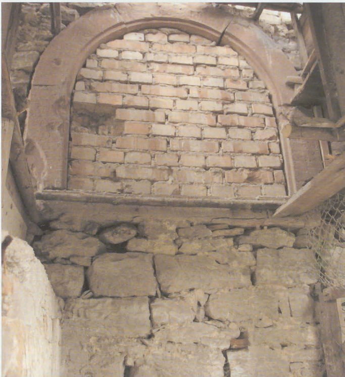
Gewände des Fensters über dem Thoraschrein. Darüber das zerfallene Dach des Hühnerstalles des Nachbarn L.
